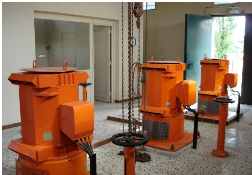
Pompage de Saint Vit
